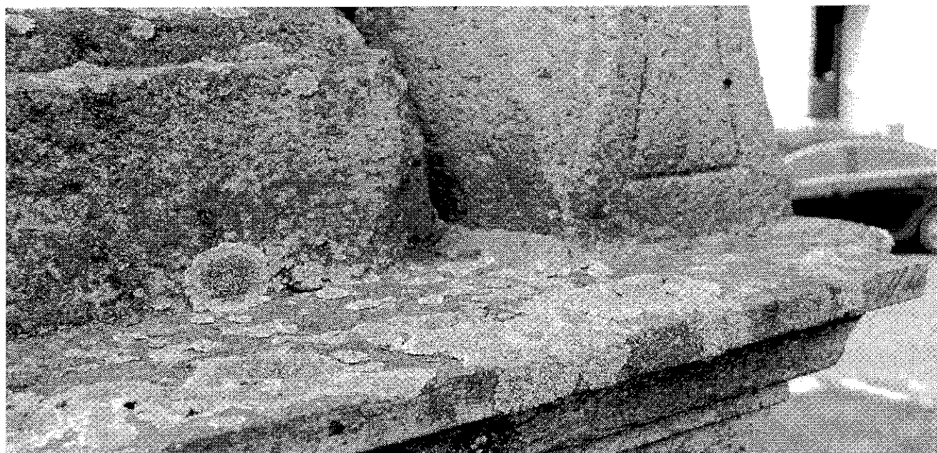
Obr. č. 16: Horní vodorovná plocha bloku „korunní“ římsy, oddělující spodní část podstavce od horní části s figurálními skulpturami. Silné znečištění a biologické napadení povrchu mechy a lišejníky, jejichž vlivem dochází k naleptávání kamene a vydrolování křemičitých zrn.
